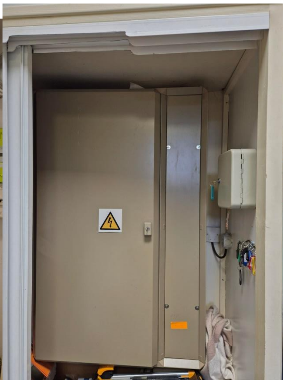
Armoire électrique (bureau de la direction, bâtiment maternelle)
